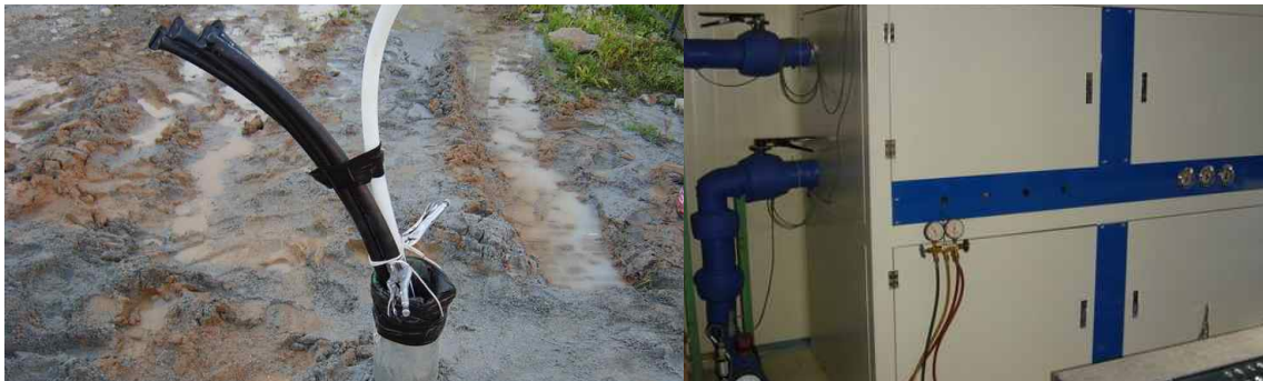
그림2-25. 지열원 열교환기 및 히트펌프
