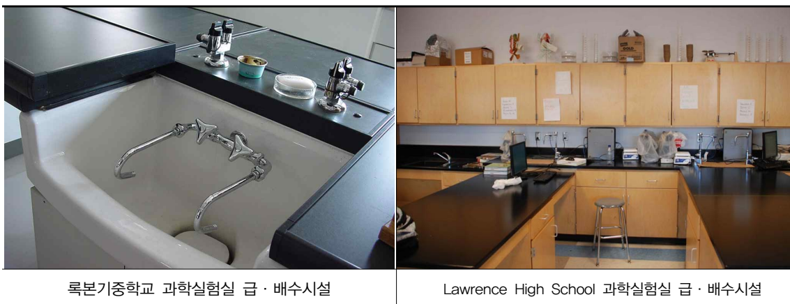
그림4-32. 과학실 실험실 급·배수시설
